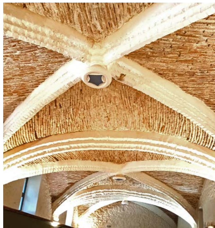
Detall de les magnífiques voltes de creueria de l'antic celler de la casa Jalpí.
