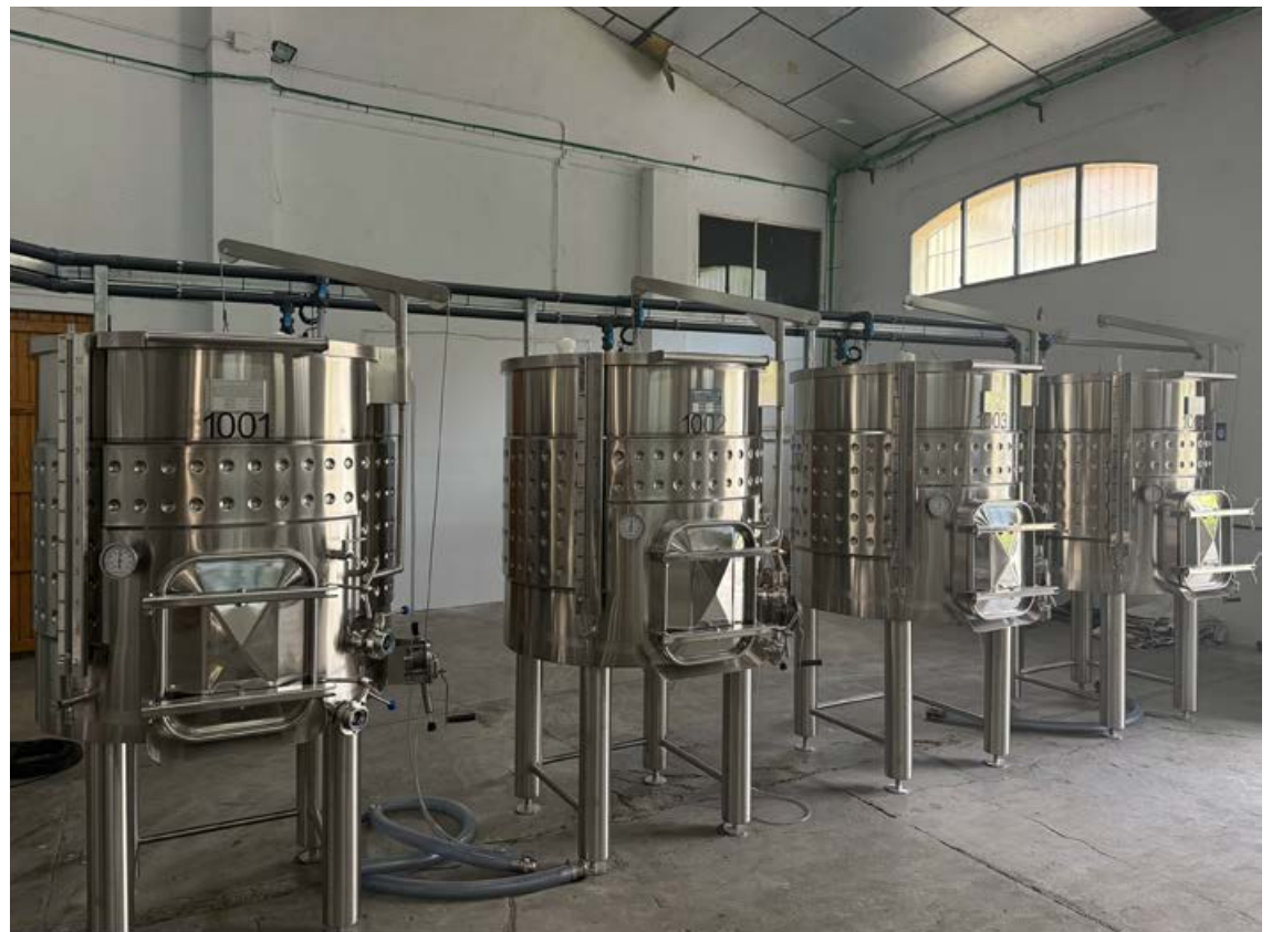
Quatre dipòsits de mil litres, nous de trinca, al celler.
