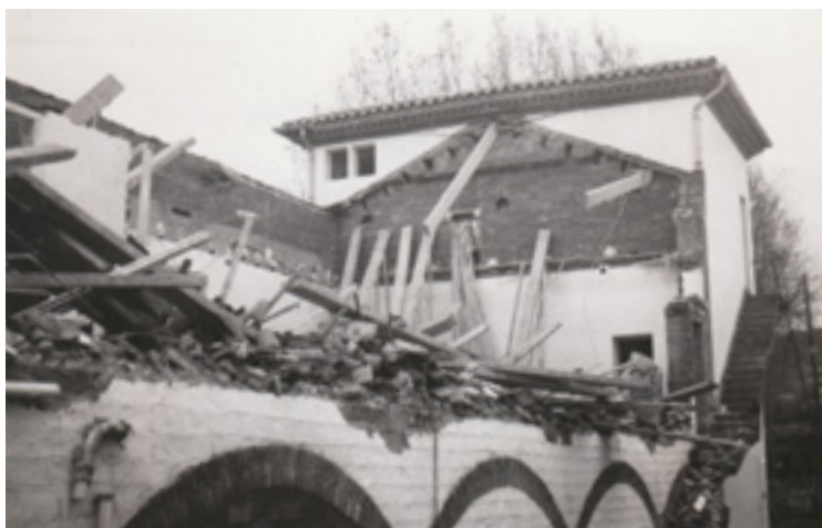
Aspecte de les oficines del Sindicat just després de l'esfondrament de la teulada durant la seva construcció.
